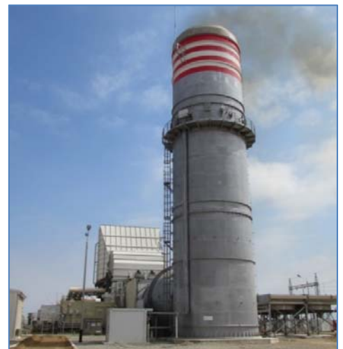
Unidad de generación turbina a gas
