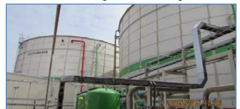
Tanques de almacenamiento de agua
